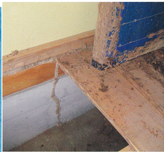
床下からあがる蟻道
